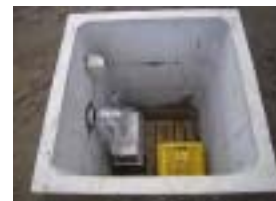
バケット流量計設置排水ます
