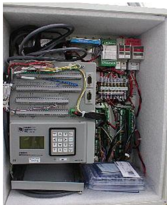
計測ボックスの内部の例 (C-CR3000)電源系は別箱
