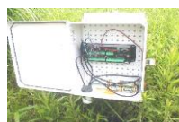
↑データ収録装置の例 C-CR1000 及び、電源(乾電池)、計測ケーブル
